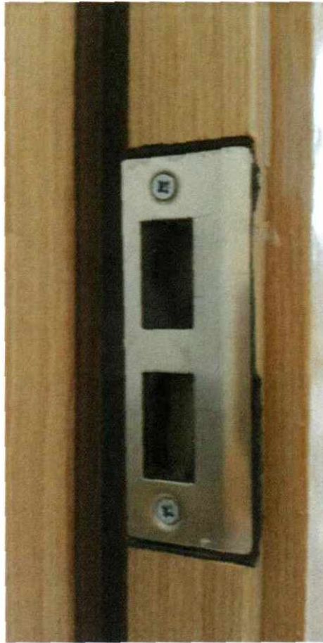
Şekil 8. Kilit Dili Yuvası ve Altında Bulunan Şişen Conta
